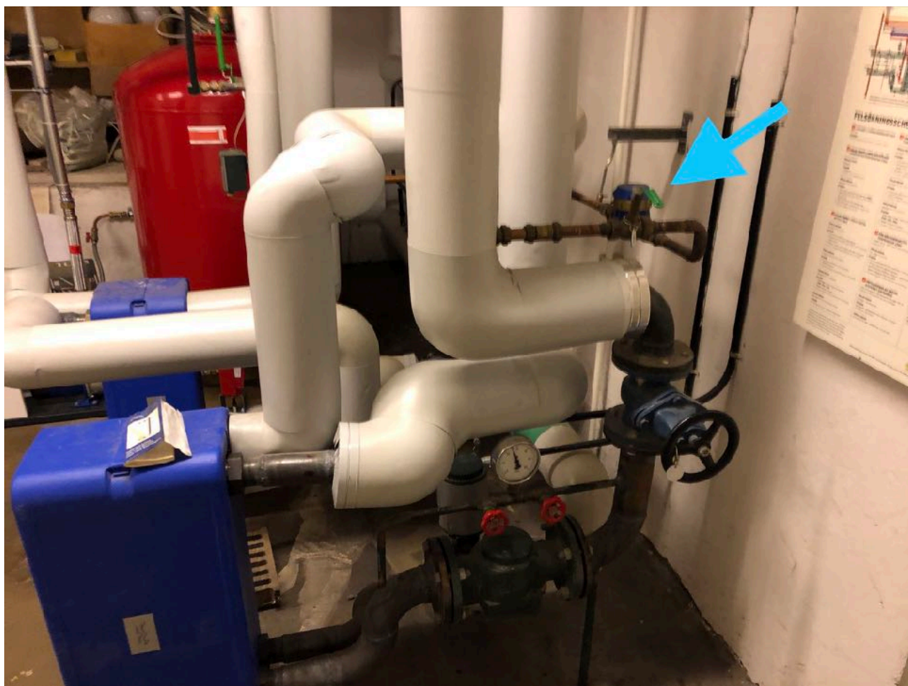
Fig 8. Påfyllningskran för värmesystemet
