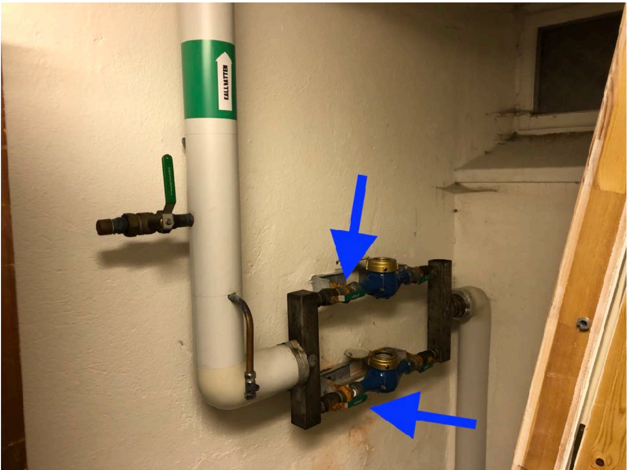
Fig 1. Avstängning av kranvatten
