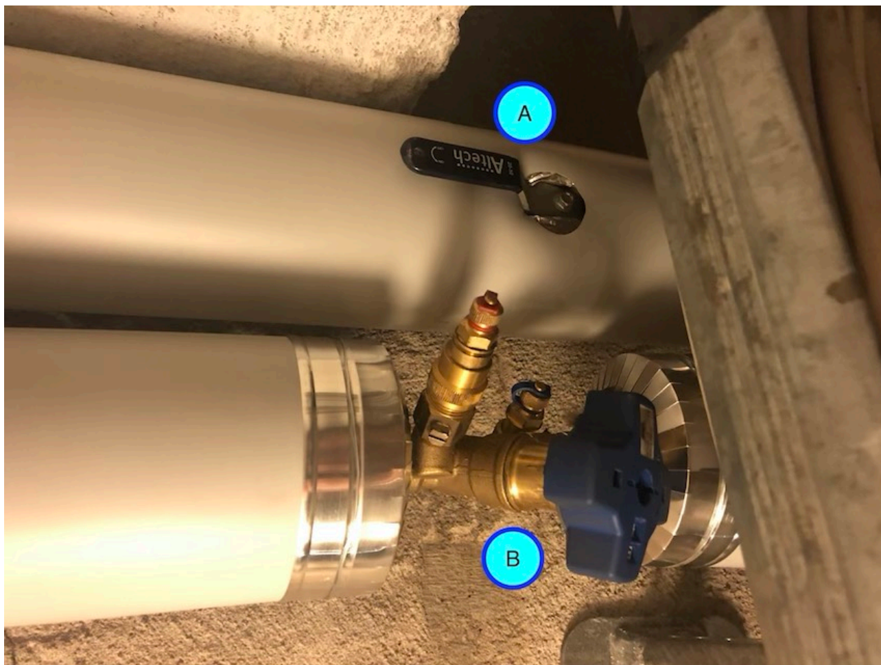
Fig 5. Kranar för avstängning av del av värmesystemet
