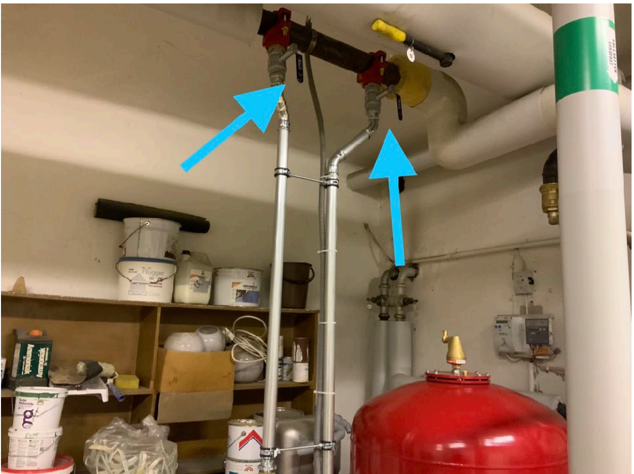
Fig 4. Vred för avstängning av vatten från tryckkärl
